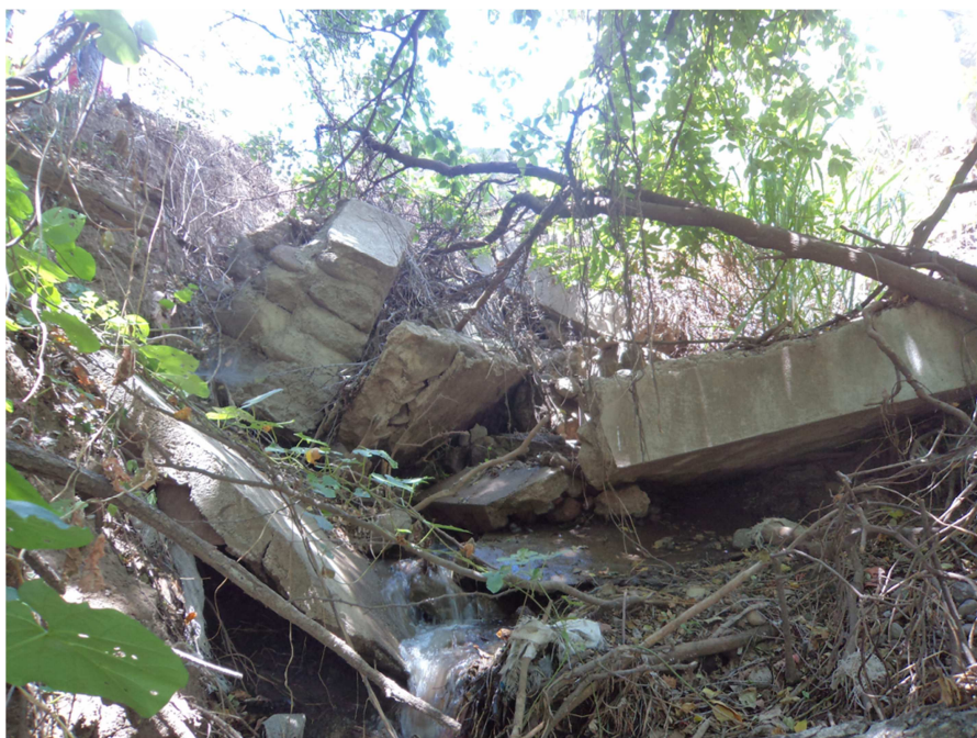
Foto 11. Los daños de la alcantarilla en La Chimpinilla, Sébaco, los aletones sucumbieron. Foto: Marbely García
